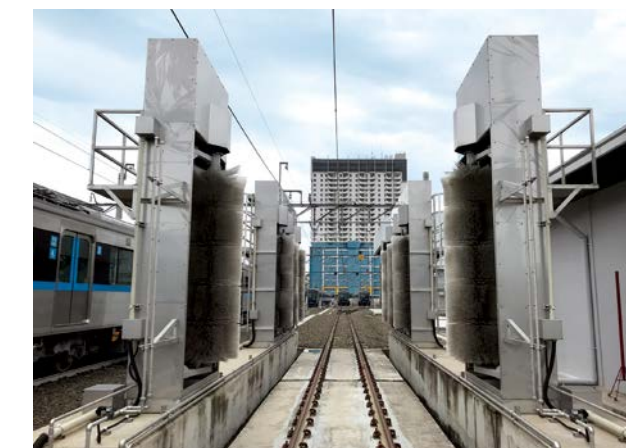
ジャカルタ都市高速鉄道 洗浄設備
