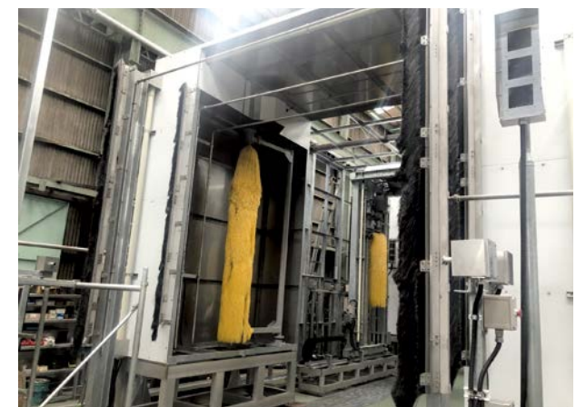
香港国際空港 洗浄設備
